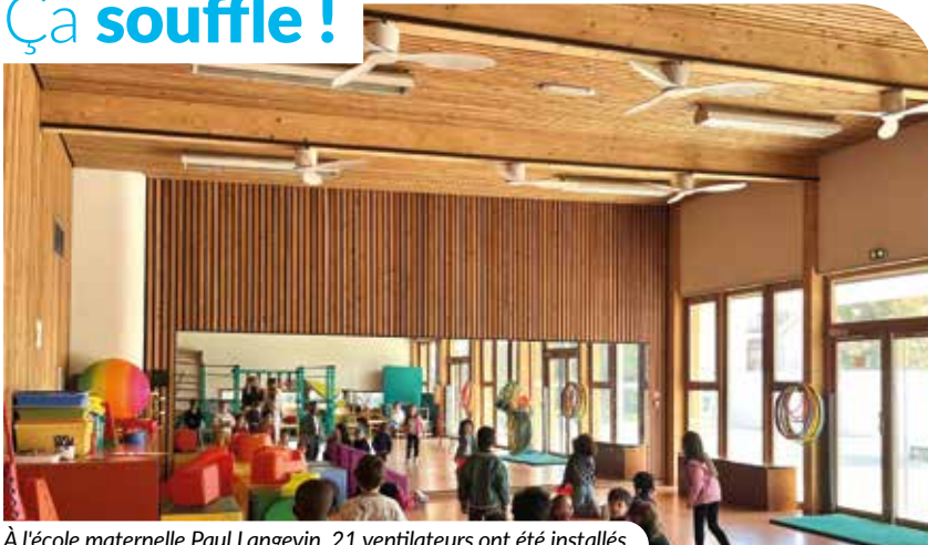
À l'école maternelle Paul Langevin, 21 ventilateurs ont été installés.
